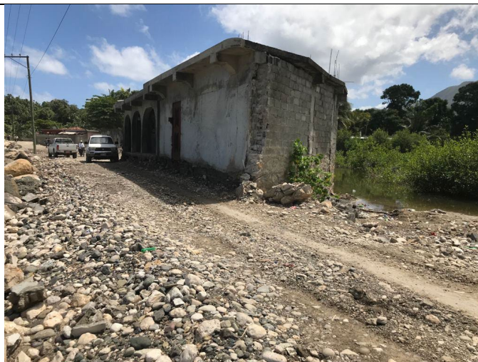
Déviation pont 2 endommagée par les vagues de la mer
